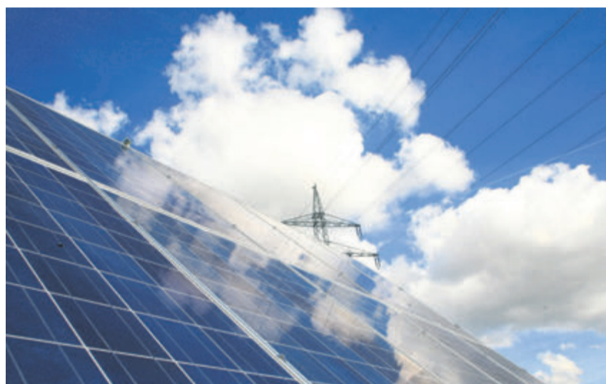
Photovoltaik-Element mit Strommast.
