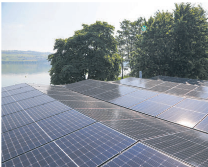
Auf dem Dach des Restaurants bei der Badi Nottwil realisierte die Genossenschaft «e-nottwil» ihre erste Photovoltaikanlage. FOTO ZVG
