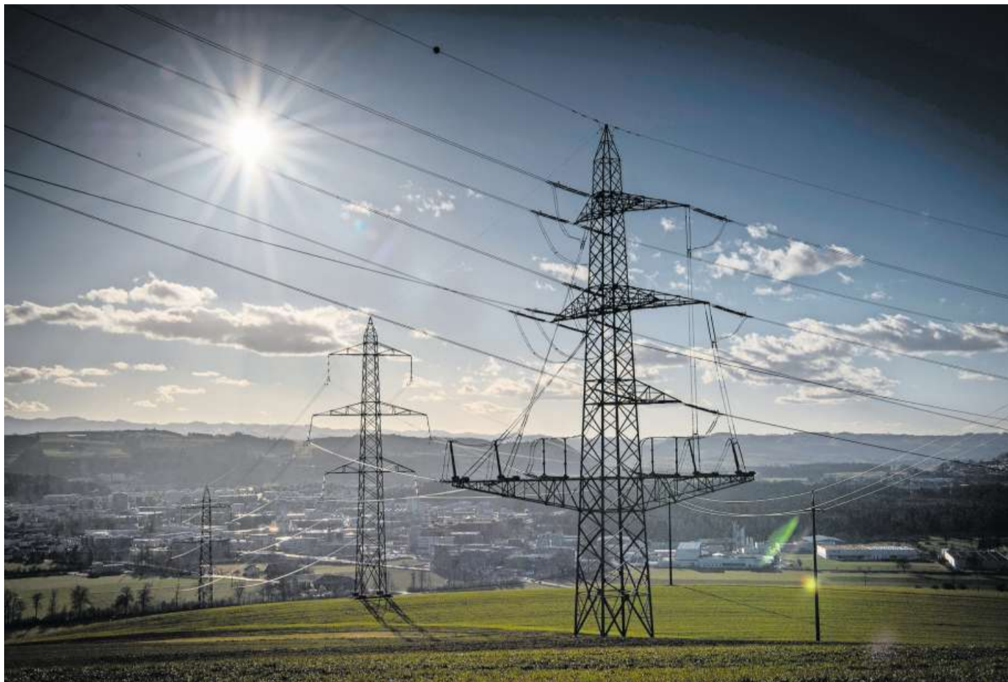
Starkstromleitungsmasten auf dem Gemeindegebiet von Schenkon.
