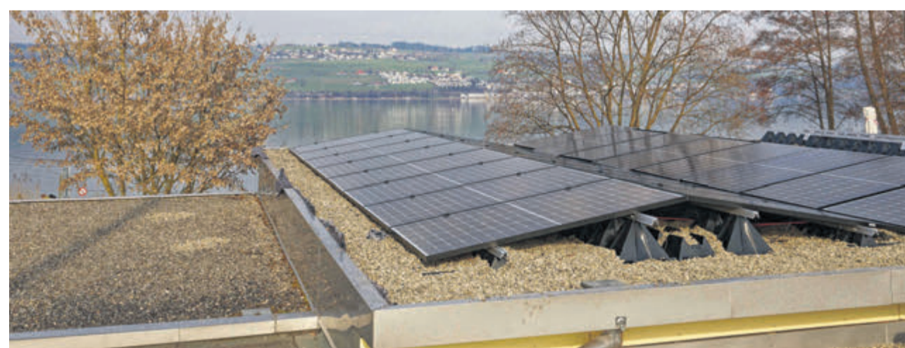
Die Anlage auf dem Dach des Seebads Nottwil.
