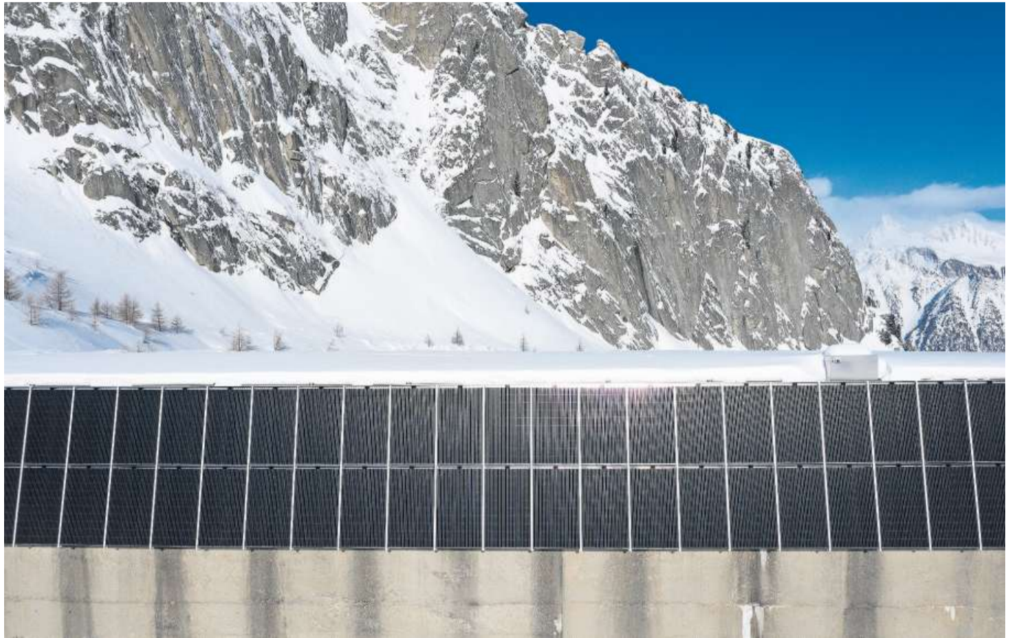
Die hochalpine Solaranlage der Elektrizitätswerke der Stadt Zürich (EWZ) an der Albigna-Staumauer.
